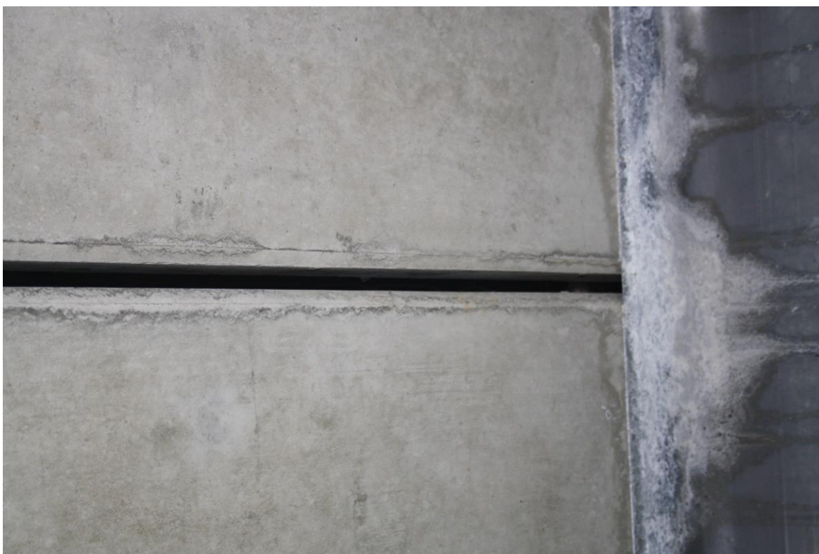
Abbildung 3: Fugen zwischen den Betonplatten des Parkhauses.
