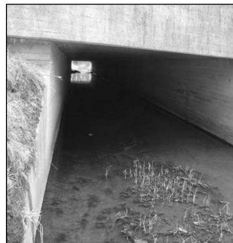
Autobahndurchlass BAB A7 mit Schlammauflage
